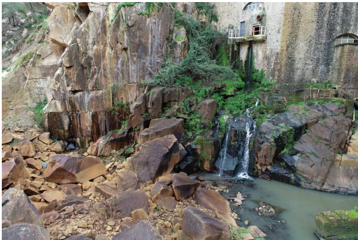
Figura 1: Perdite d'acqua in roccia in corrispondenza della sponda destra a valle diga.
