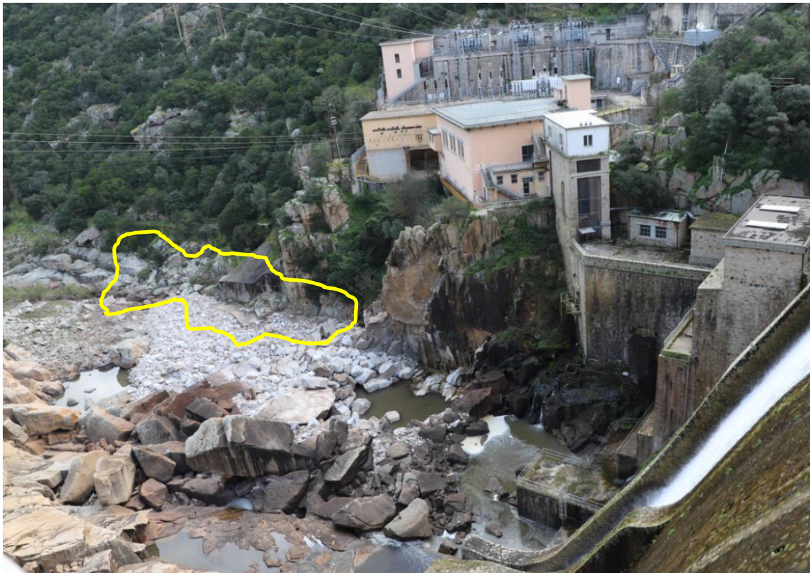
Figura 11: vista del deposito da crollo recente.
