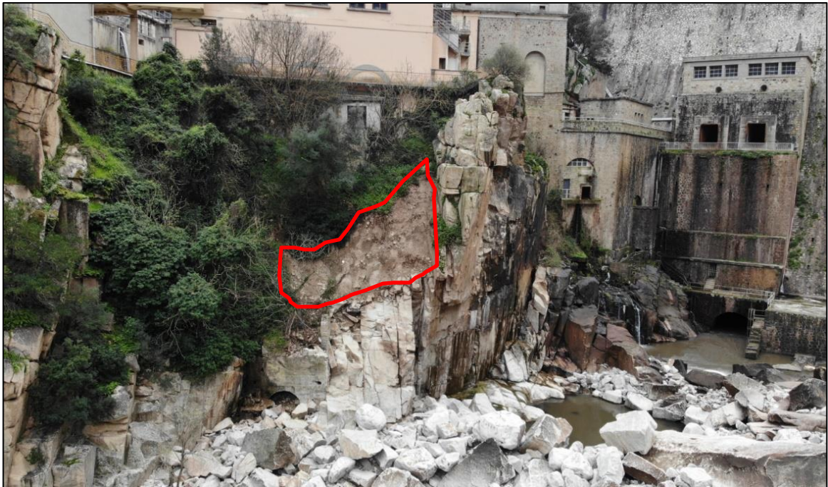
Figura 12: Estensione della frana superficiale in suolo lungo il margine destro a valle del corpo della diga.
