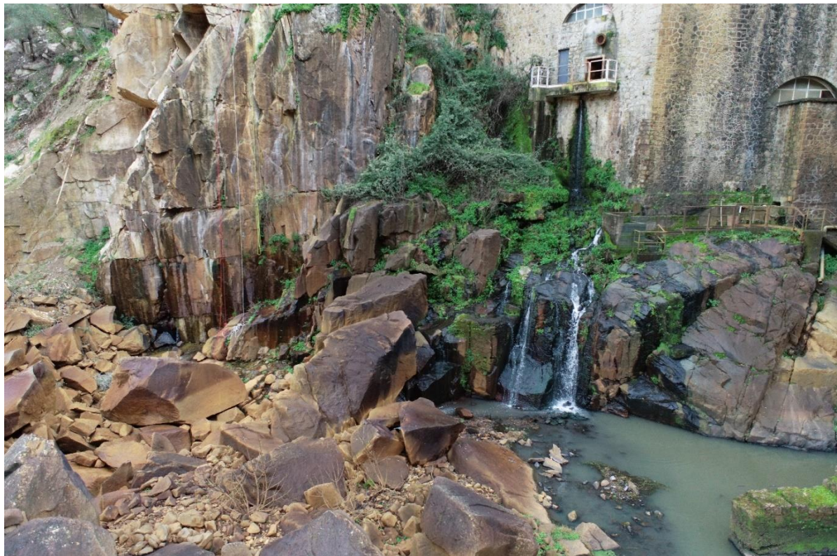
Figura 2: Perdite d'acqua in roccia in corrispondenza della sponda destra a valle diga.
