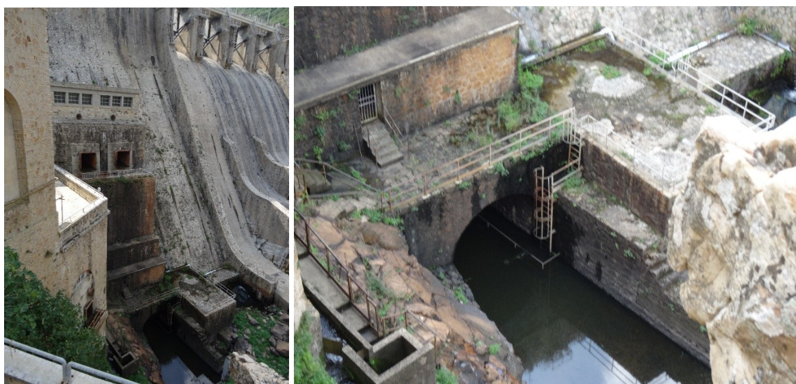
Figura 5: Diga di Muzzone – Vista da valle: Stato di fatto scarico di fondo e scarico di alleggerimento.
