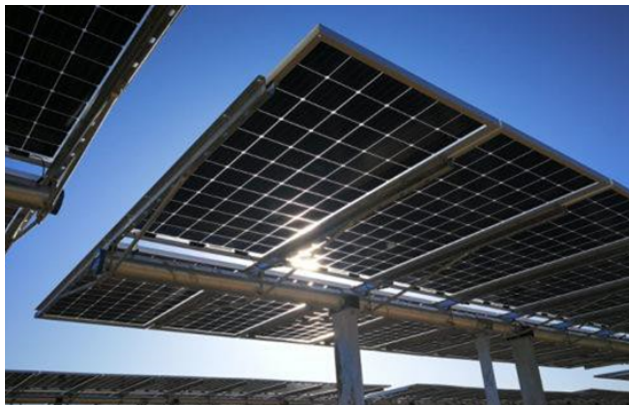
Figura 15 - Particolare strutture di sostegno moduli
