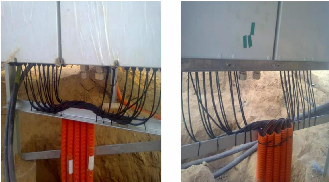
Figura 6-6 - Collegamento cavi CC per i moduli fotovoltaici
