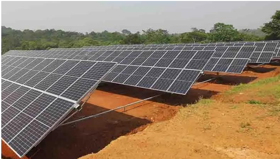
Figura 6-5 - Esempio del risultato finale dopo il completamento del montaggio dei moduli fotovoltaici
