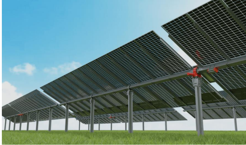
Figura 5-3 – Esempio di impianto con inseguitori solari monoassiali 2P
