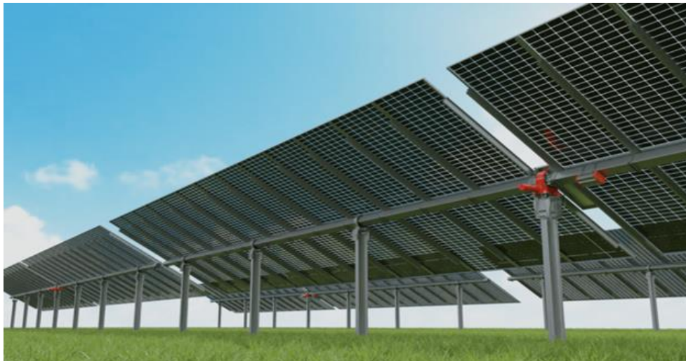
Figura 6-3 – Esempio di impianto con inseguitori solari monoassiali 2P
