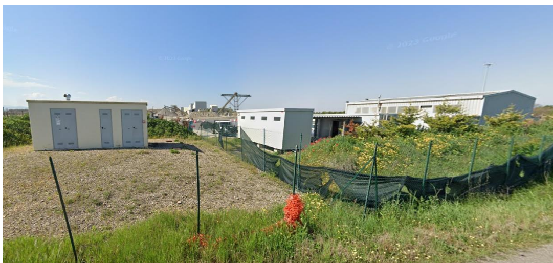
Figura 6-6 - Fotografie di locali e impianti tecnici ubicati nel territorio limitrofo all'area di progetto.
