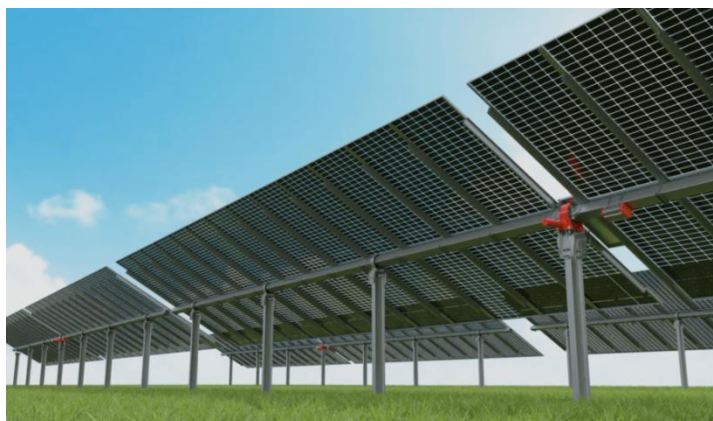
Figura 9-2 - Esempio di impianto con inseguitori solari monoassiali 2P
