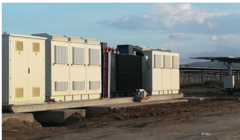
Figura 15 - Esempio skid conversione
