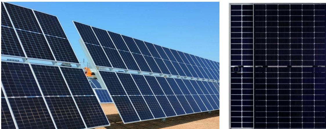
Moduli fotovoltaici su tracker mono assiali
