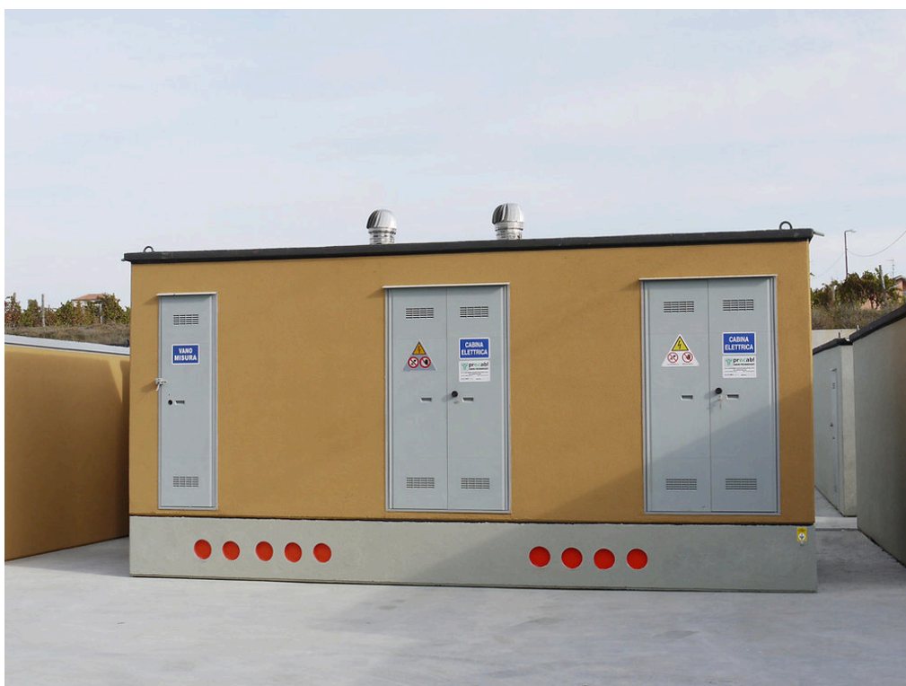
Cabina Prefabbricata pronta all'installazione in sito. Visibile la vasca di fondazione che resta completamente interrata
