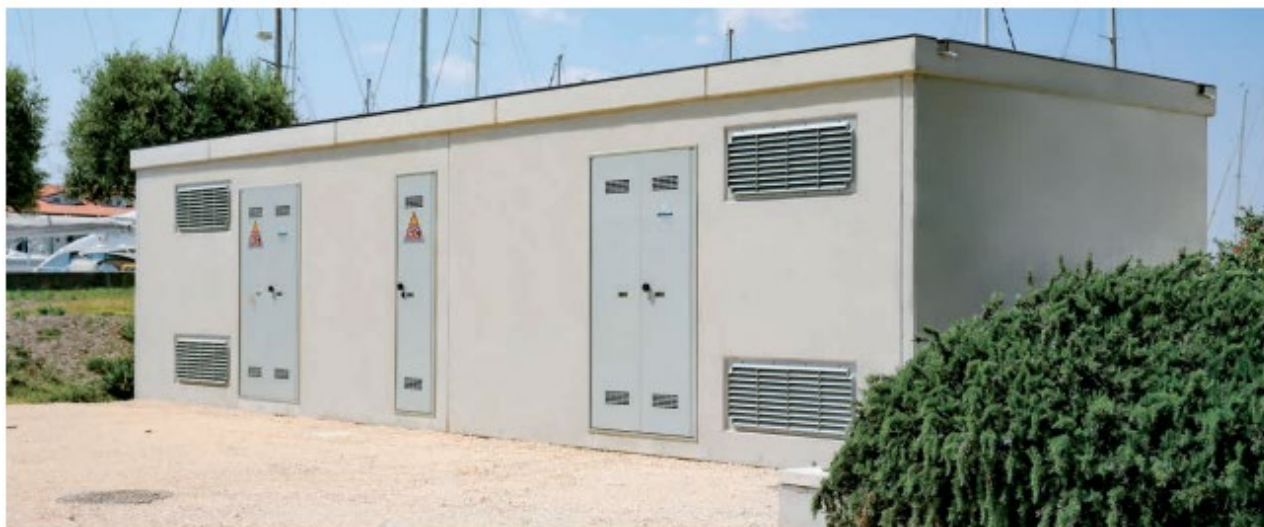
Cabina Prefabbricata installata
