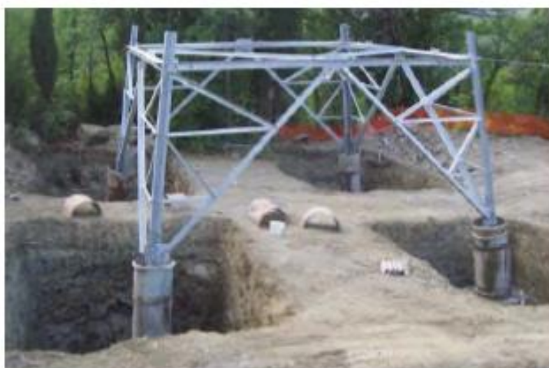
Figura 2.5.5 – Realizzazione di fondazioni superficiali tipo CR per sostegno a traliccio. Si possono osservare le quattro buche, la base del sostegno collegata alla fondazione tramite i "monconi" ed i casseri utilizzati per i quattro "colonnini"
