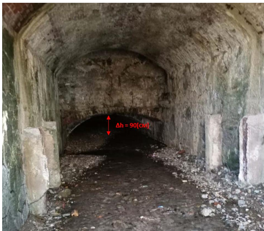
Figura 64 - Significativo ribassamento dell'intradosso della copertura del tratto tombato del Rio Grillè (Progetto Definitivo D-IDR-PR-D01-0 – Relazione idrologica idraulica e morfodinamica)
