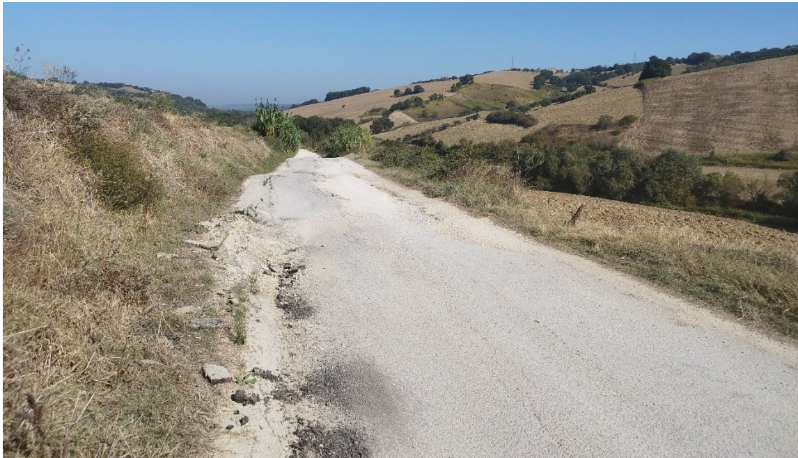
Viabilità esistente in conglomerato bituminoso in pessimo stato
