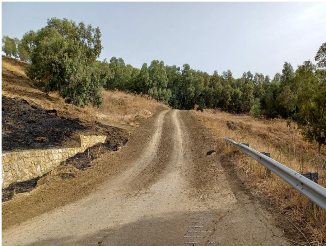
Figura 38 Cavidotto tra Parco Sud e stazione utenza, primo tratto lungo SP24: lavori di stabilizzazione della strada per fenomeni franosi attivi
