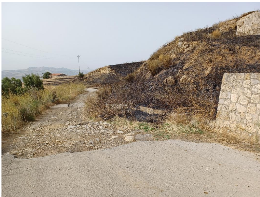
Figura 39 Cavidotto tra Parco Sud e stazione utenza, primo tratto lungo SP24: dissesto alla strada per fenomeni franosi attivi
