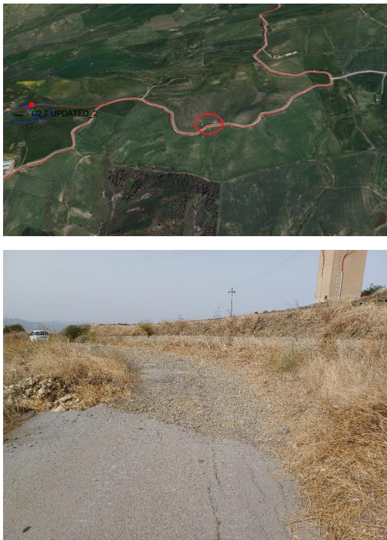
Figura 36 Dissesto strada lungo SP24 prima del Parco Sud
