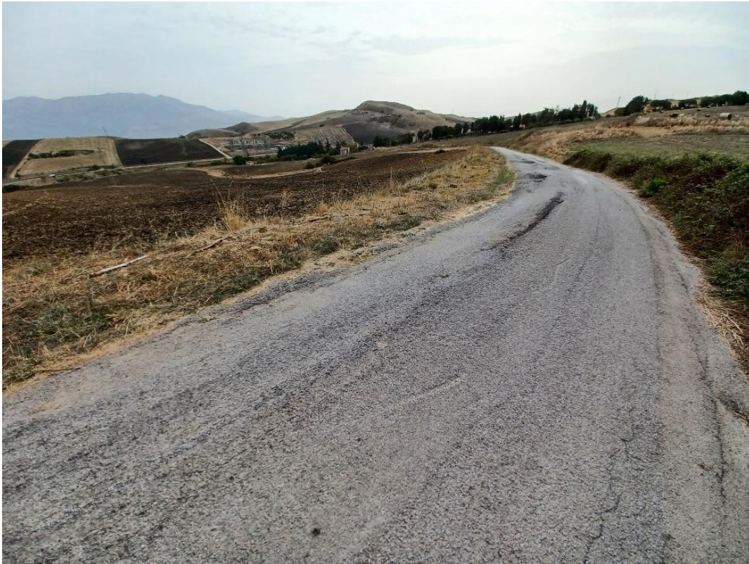
Figura 29 Danni alla strada per frana di colamento quiescente
