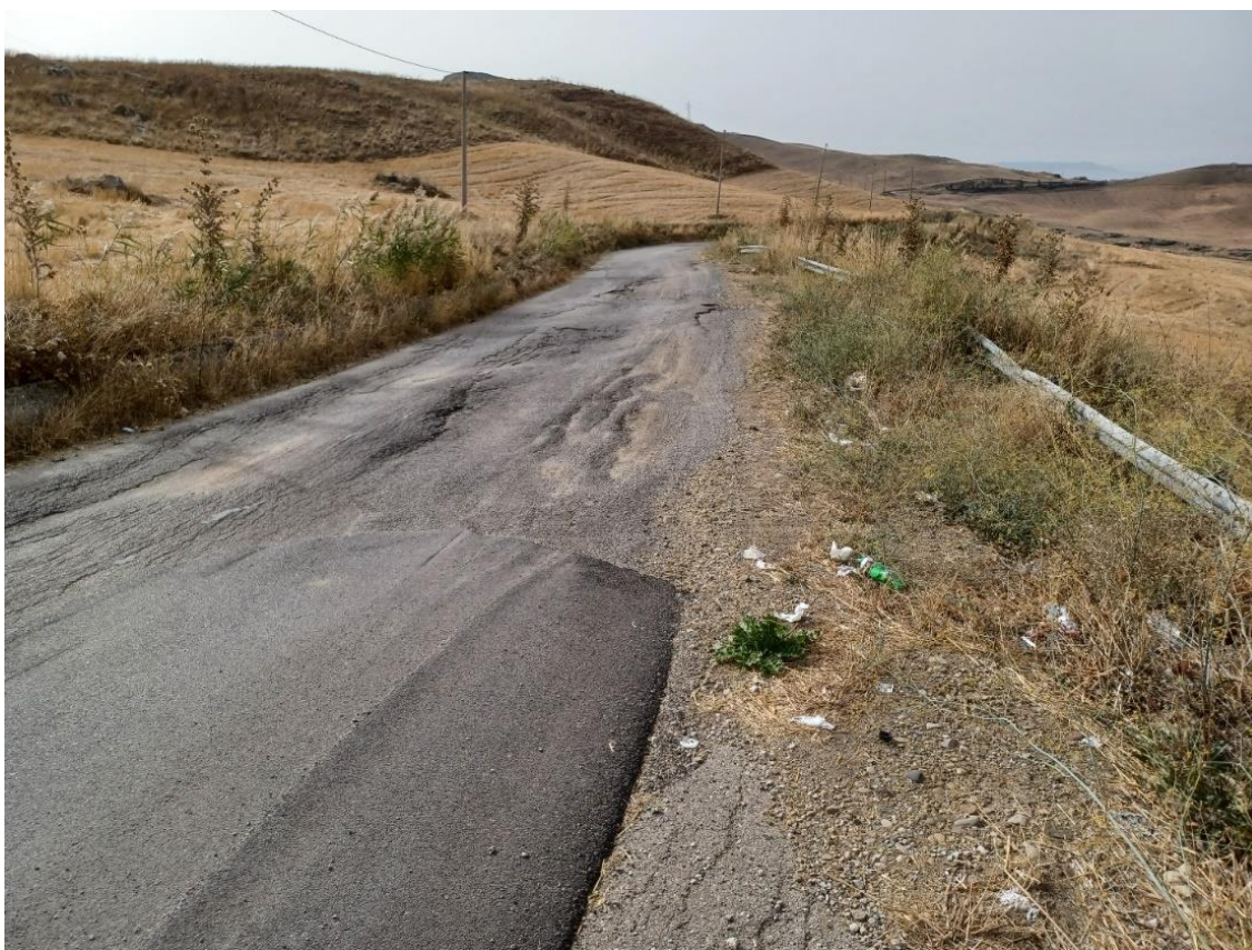
Figura 33 Cavidotto tra Parco Nord e Parco Sud, secondo tratto lungo SP24: danni alla strada in prossimità della frana di colamento quiescente
