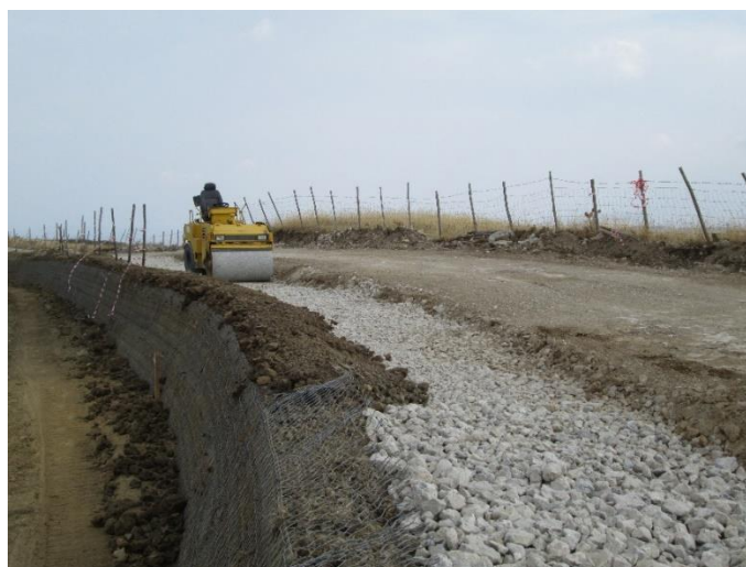
Figura 27 – Esempio di opera in terre rinforzate - Fonte HE
