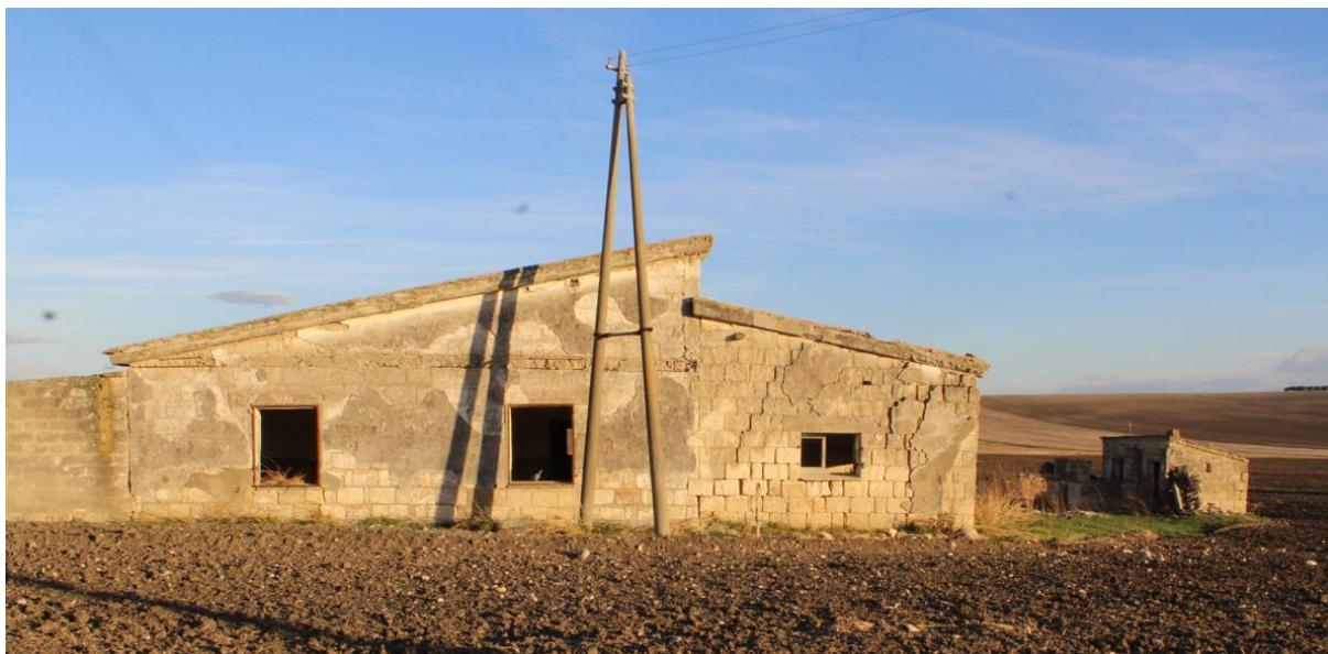
Figura 5: Fabbricato rurale diruto
