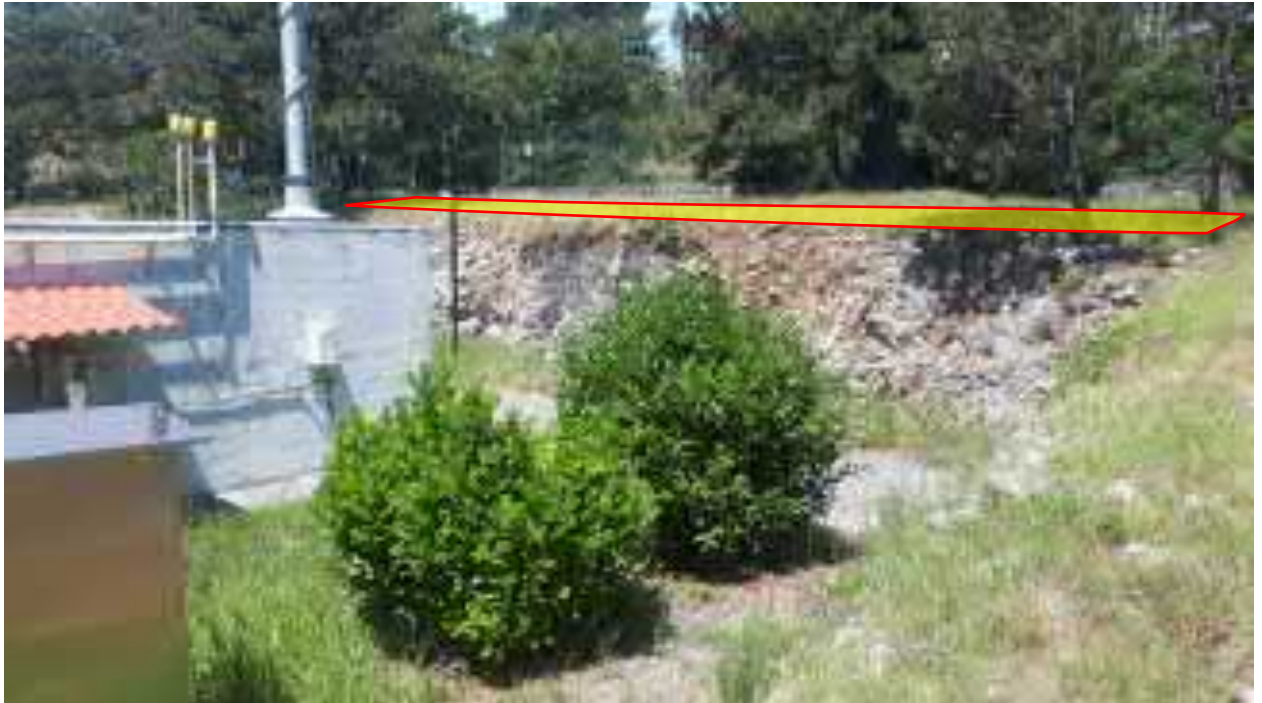
FOTO N.1 – Panoramica Area di Stacco impianto PIDI n.1 all'interno dell'esistente impianto cabina n.906/A in comune di Monfalcone
