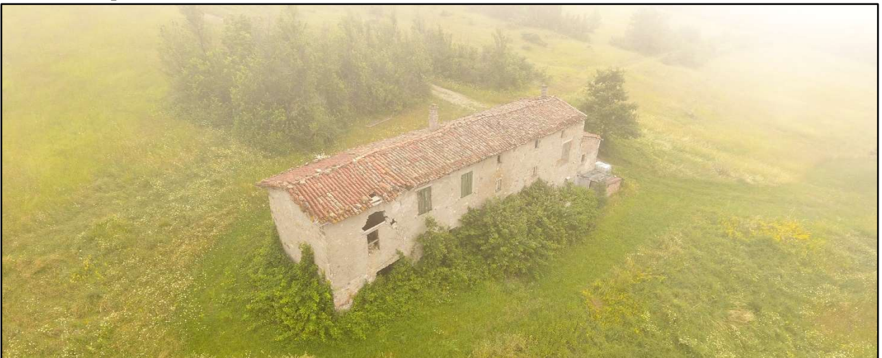
Foto 11a: R11-Fabbricato Diruto
