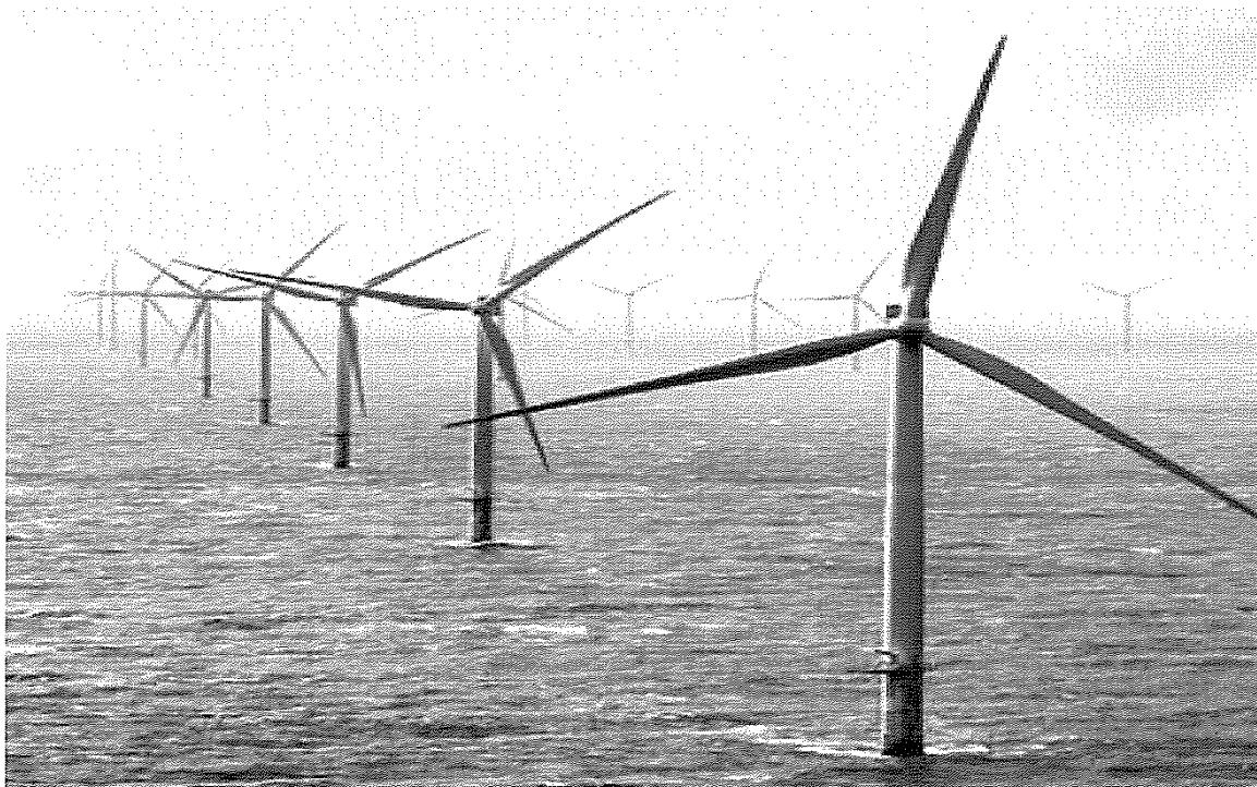
Figura 4.4: Esempio di Aerogeneratore
