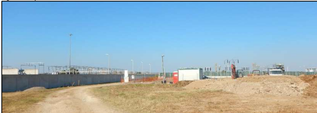
Figura 2.3.2j Stazione Elettrica "Tuscania" esistente
