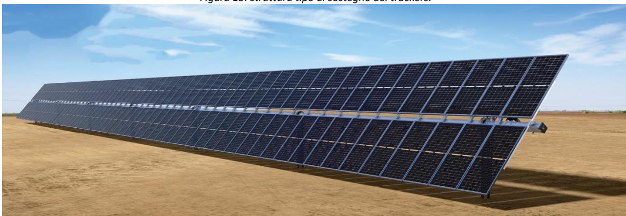
Figura 16: trackers tipo con pannelli installati.
