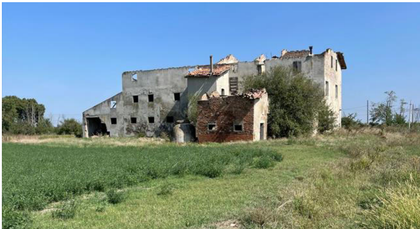
Figura 3: Fabbricato rurale diruto
