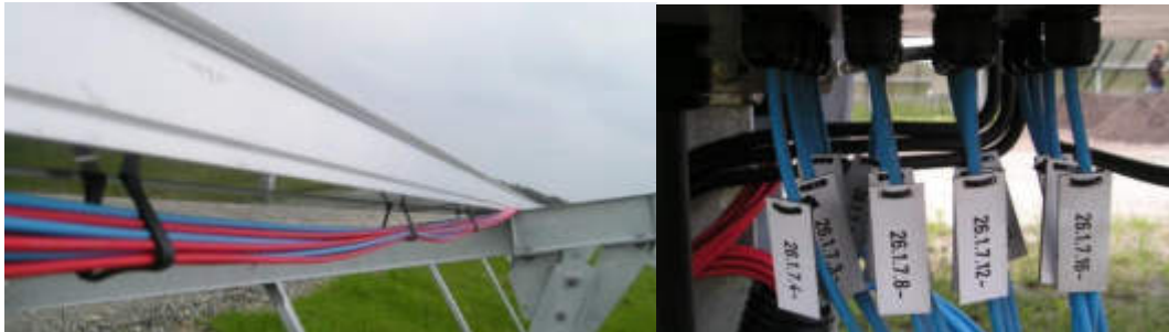
Figura 6: Conduttori DC (lato BT)
