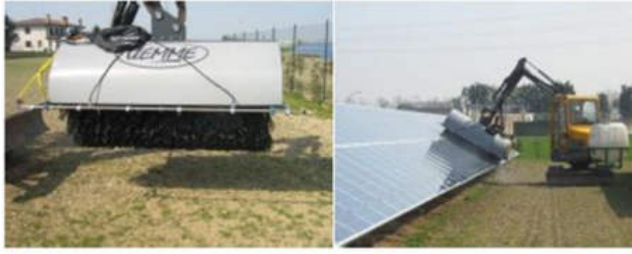
Figura 19: Dispositivi di pulizia moduli - Pulizia dei moduli
