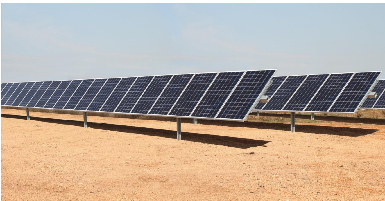
Figura 10 – Strutture di sostegno dei moduli "tracker"
