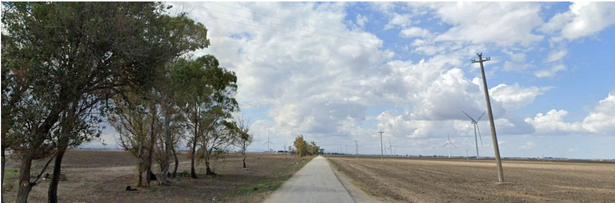
Linea elettrica MT
