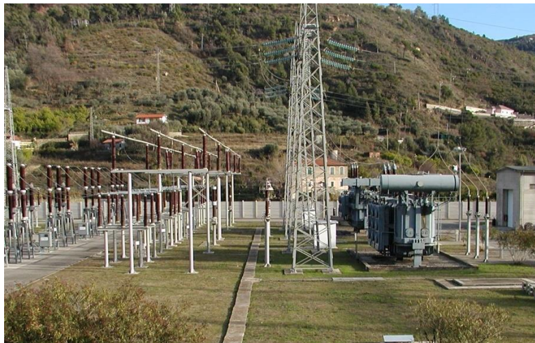
Figura 1.2: Esempio di sottostazione di trasformazione
