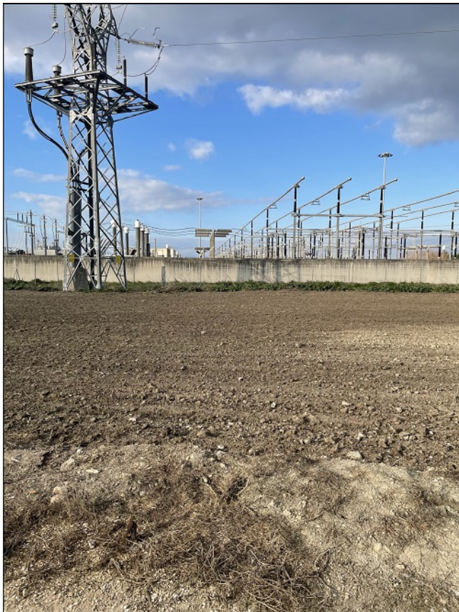
La SE 380/150 kV Foggia, vista da Nord-Est
