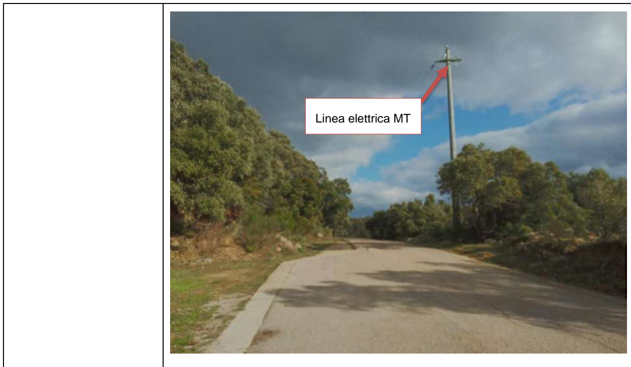
Figura 70-Cono 140_ Linea elettrica aerea (Coordinate UTM 32N 518624m E, 4529411m N)
