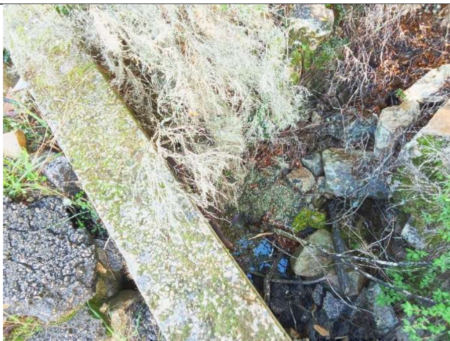
Figura 147 – Cono 26_Chiusino afferente al probabile passaggio delle condotte di drenaggio delle acque meteoriche
