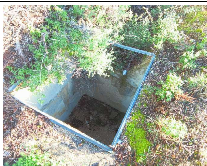
Figura 141-Cono 13_ Chiusino afferente al probabile passaggio delle condotte di drenaggio delle acque meteoriche (Coordinate UTM 32N 521718m E, 4525401m N)
