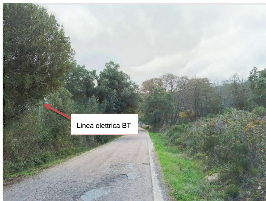
Figura 68-Cono 136_ Linea elettrica aerea (Coordinate UTM 32N 517562m E, 4529862m N)
