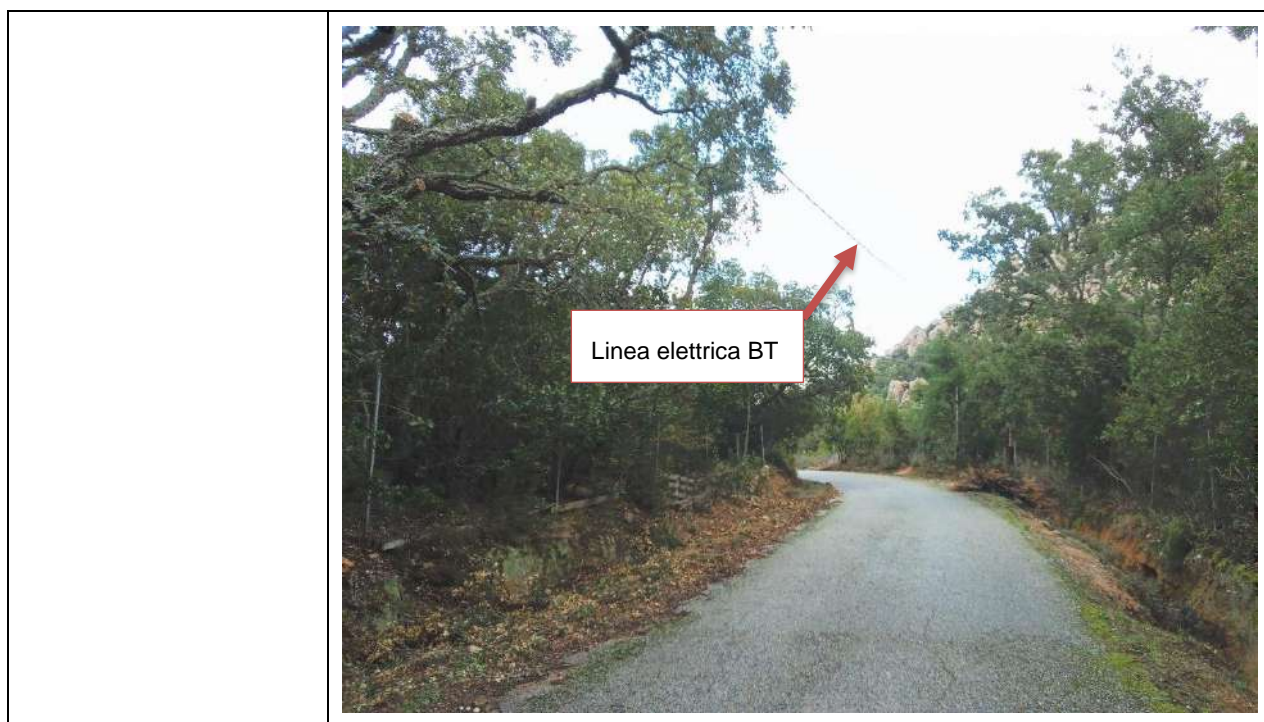
Figura 77-Cono 63_ Linea elettrica aerea (Coordinate UTM 32N 520904m E, 4530648m N)
