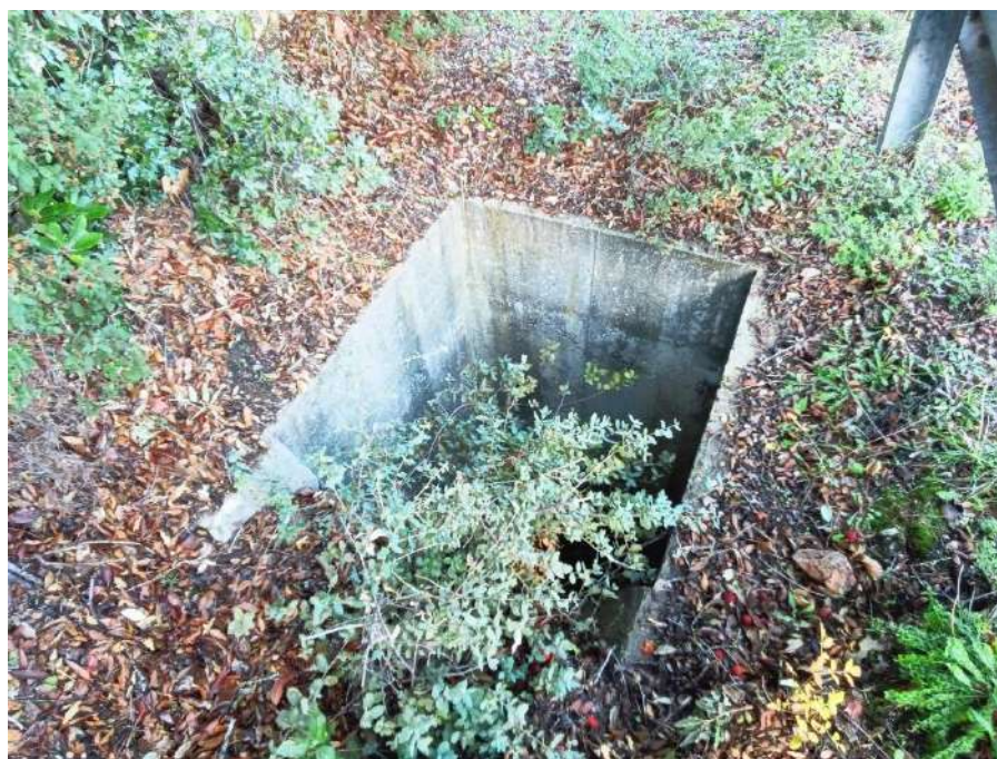
Figura 140 – Cono 11_ Chiusino afferente al probabile passaggio delle condotte di drenaggio delle acque meteoriche (Coordinate UTM 32N 521629m E, 4525165m N)
