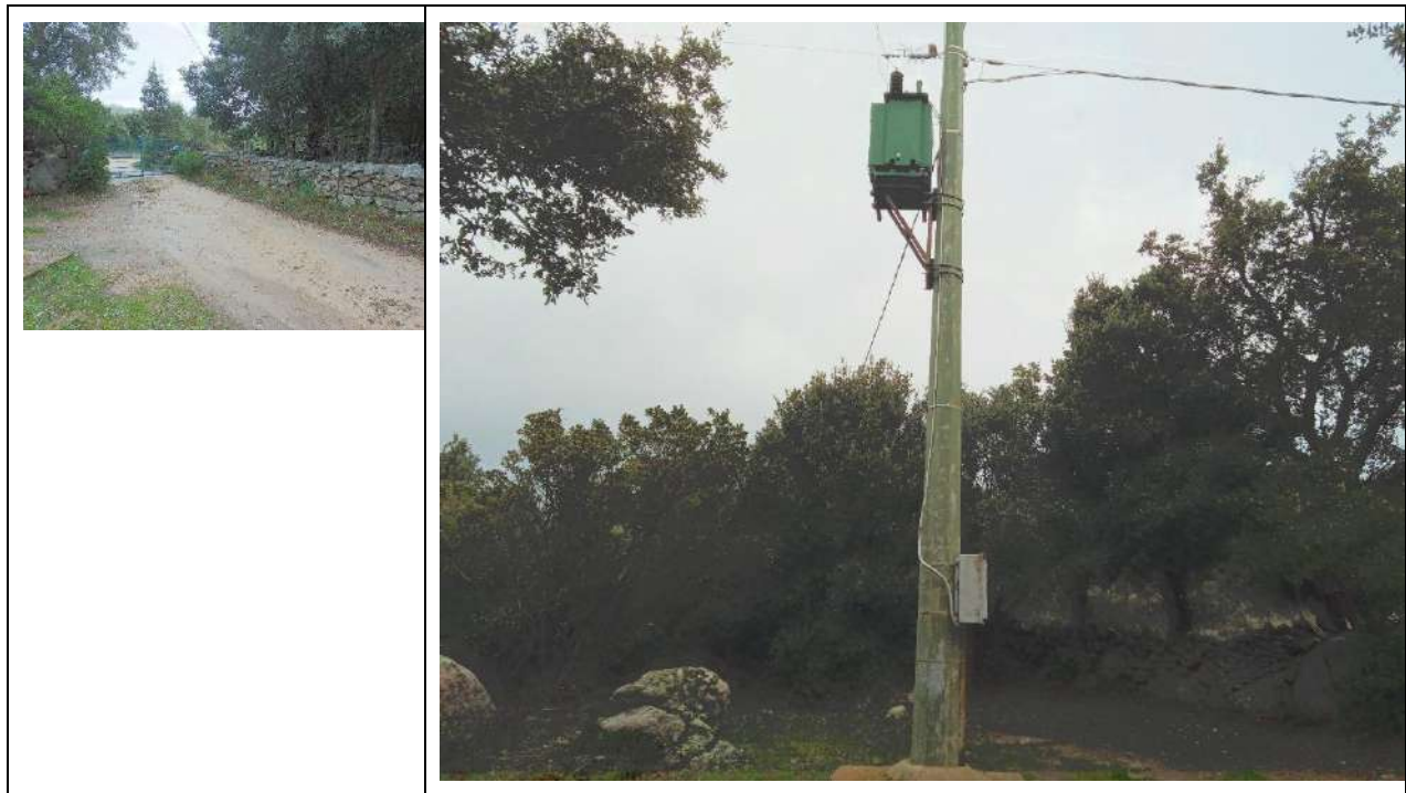
Figura 73-Cono 58_ Linea elettrica aerea (Coordinate UTM 32N 520566m E, 4530333m N)
