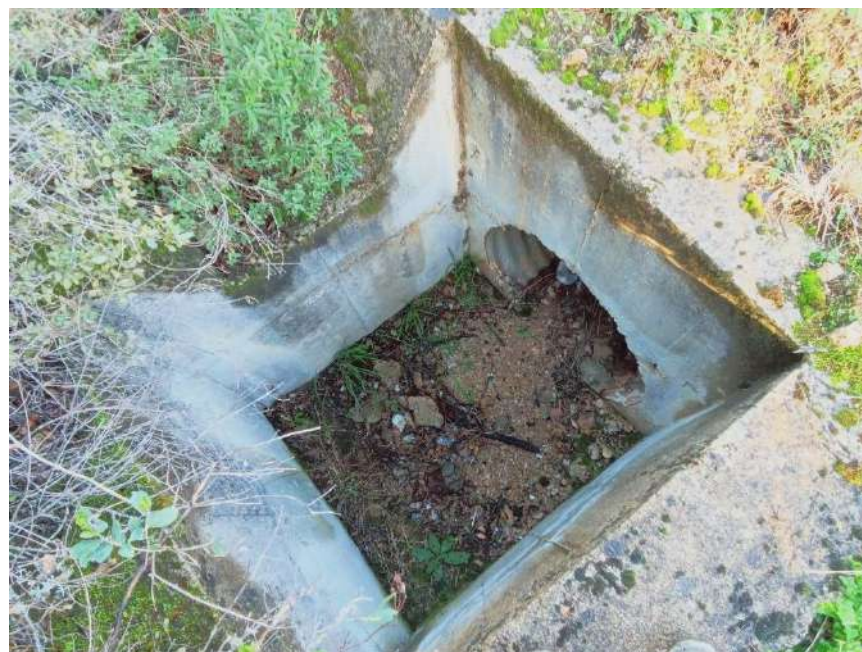
Figura 145 – Cono 17_Chiusino afferente al probabile passaggio delle condotte di drenaggio delle acque meteoriche (Coordinate UTM 32N 521547m E, 4525589m N)
