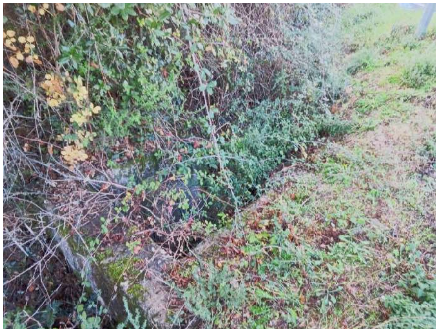
Figura 138 – Cono 9_Chiusino afferente al probabile passaggio delle condotte di drenaggio delle acque meteoriche
