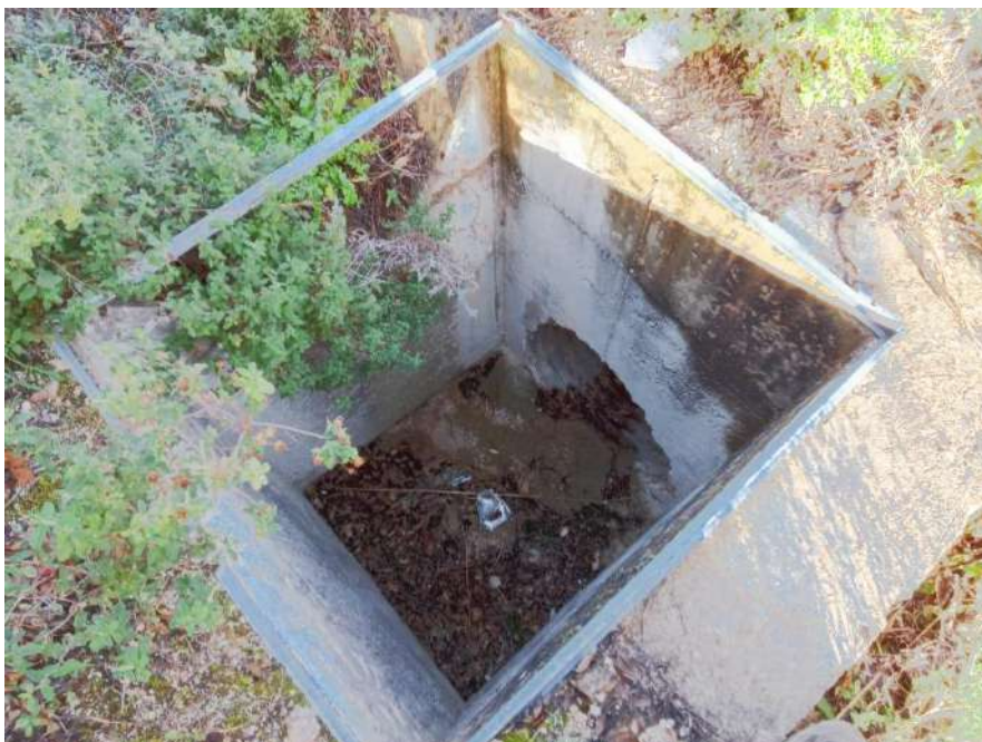
Figura 142 – Cono 14_Chiusino afferente al probabile passaggio delle condotte di drenaggio delle acque meteoriche
