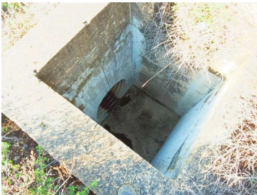
Figura 143 – Cono 15_Chiusino afferente al probabile passaggio delle condotte di drenaggio delle acque meteoriche
