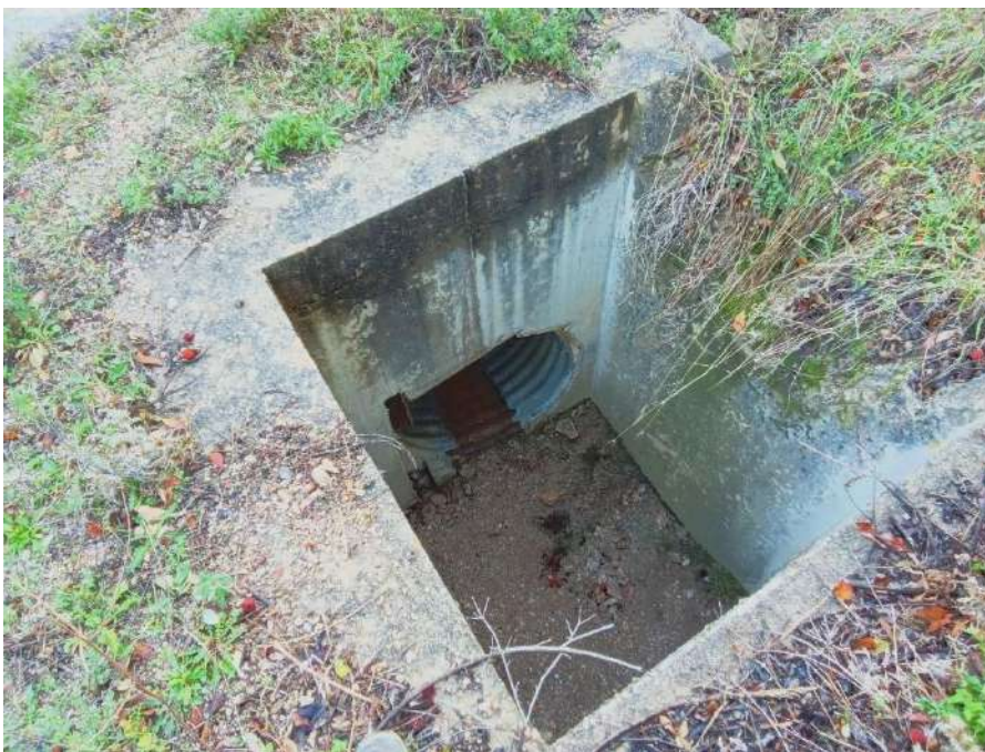
Figura 139 – Cono 10_Chiusino afferente al probabile passaggio delle condotte di drenaggio delle acque meteoriche
