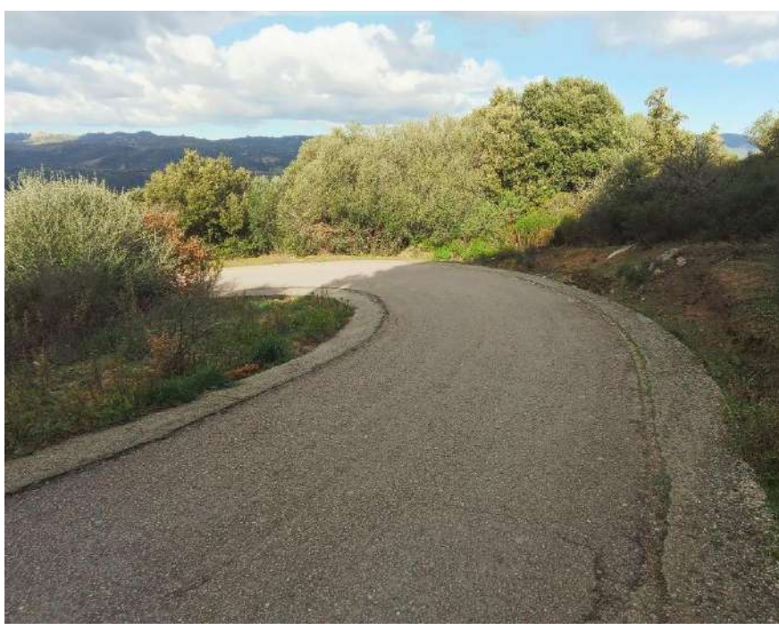
Figura 37-Cono 90_Tratto stradale con pendenza elevata (Coordinate UTM 32N 518530m E, 4533763m N)
