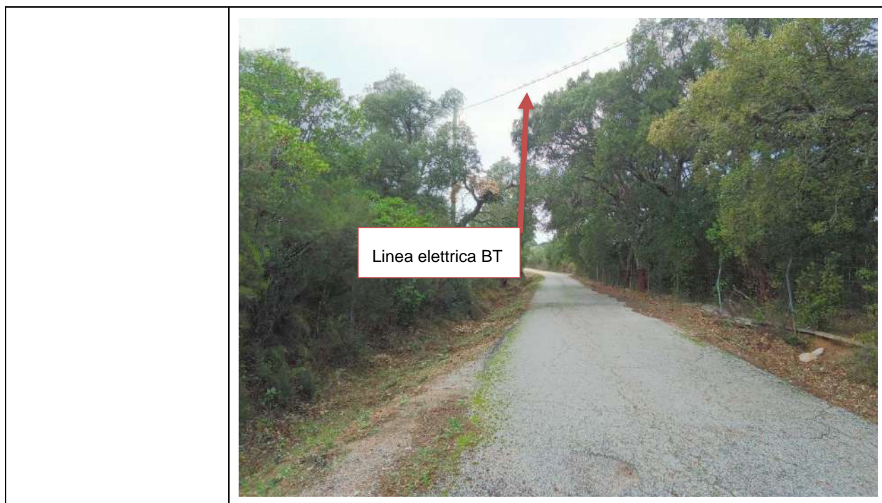
Figura 76-Cono 62_ Linea elettrica aerea (Coordinate UTM 32N 520853m E, 4530632m N)
