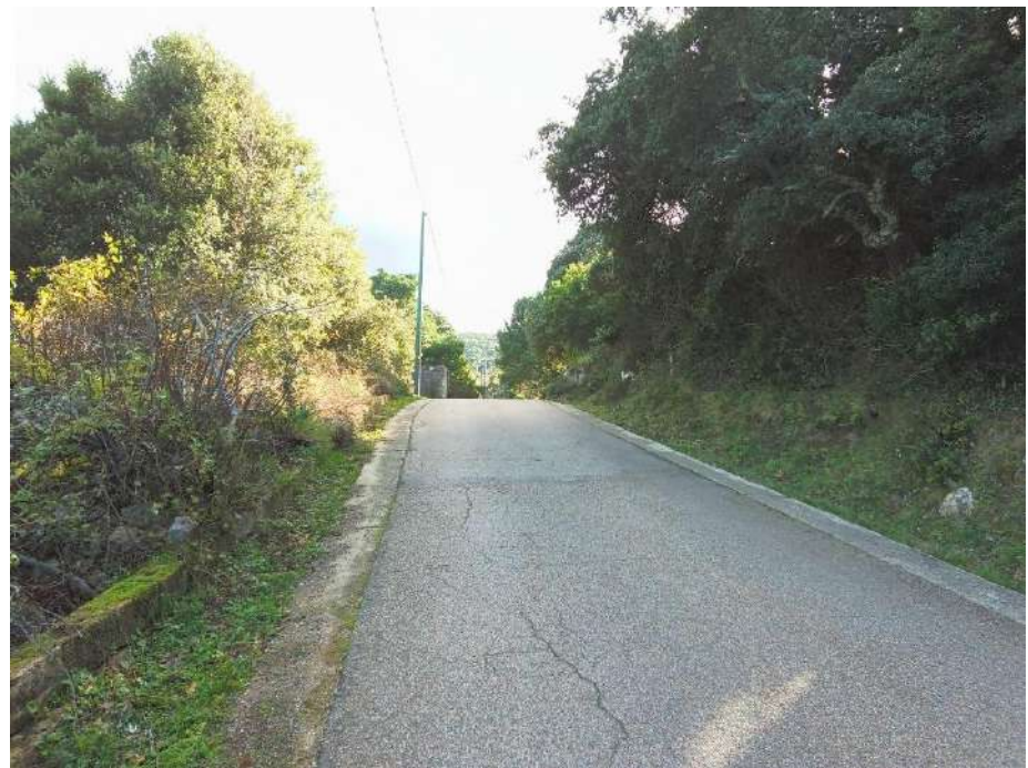
Figura 27-Cono 134_Tratto stradale con pendenza elevata (Coordinate UTM 32N 517466m E, 4530094m N)
