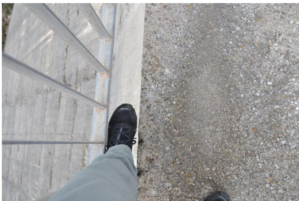
Figura 20 - Criticità del parapetto
