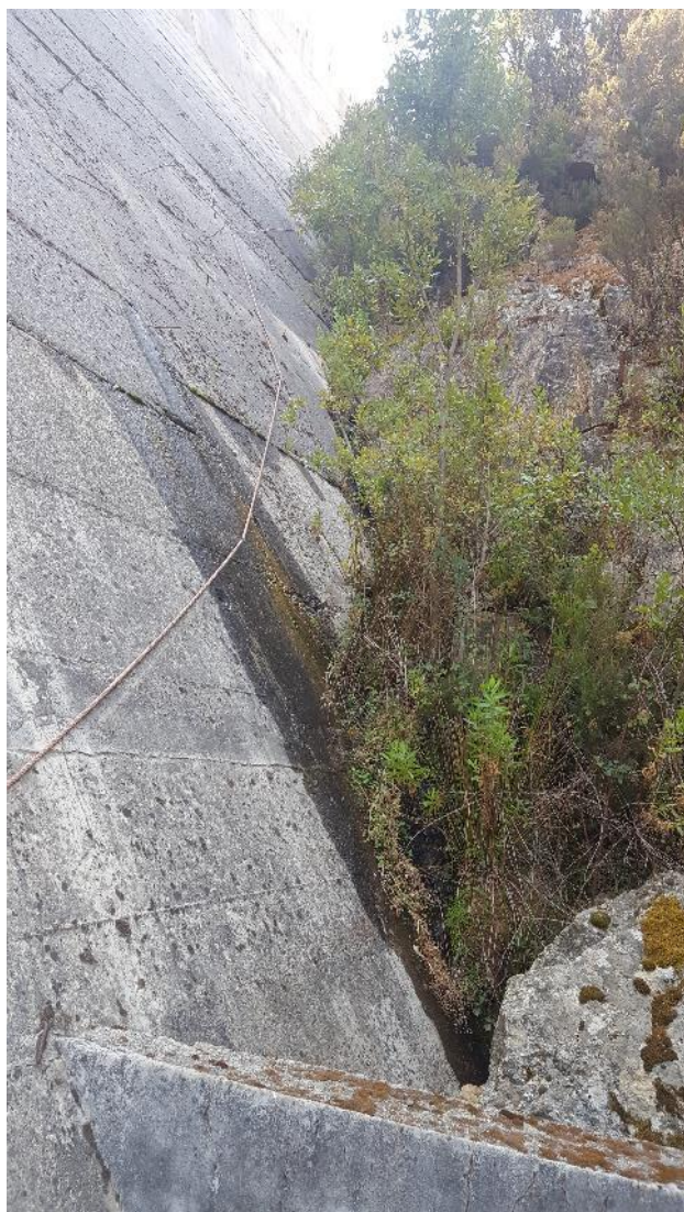
Figura 6 - Fuoriuscite di acqua in sponda sx
