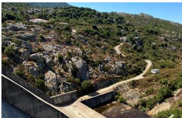
Figura 15 Viabilità interna, via di accesso al piede del rilevato ed ai cunicoli lato Sud
