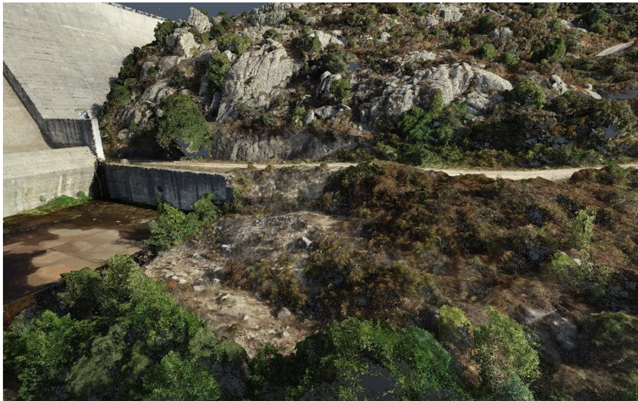
Figura 8 estratto nuvola di punti - erosione della sponda in sinistra idraulica
