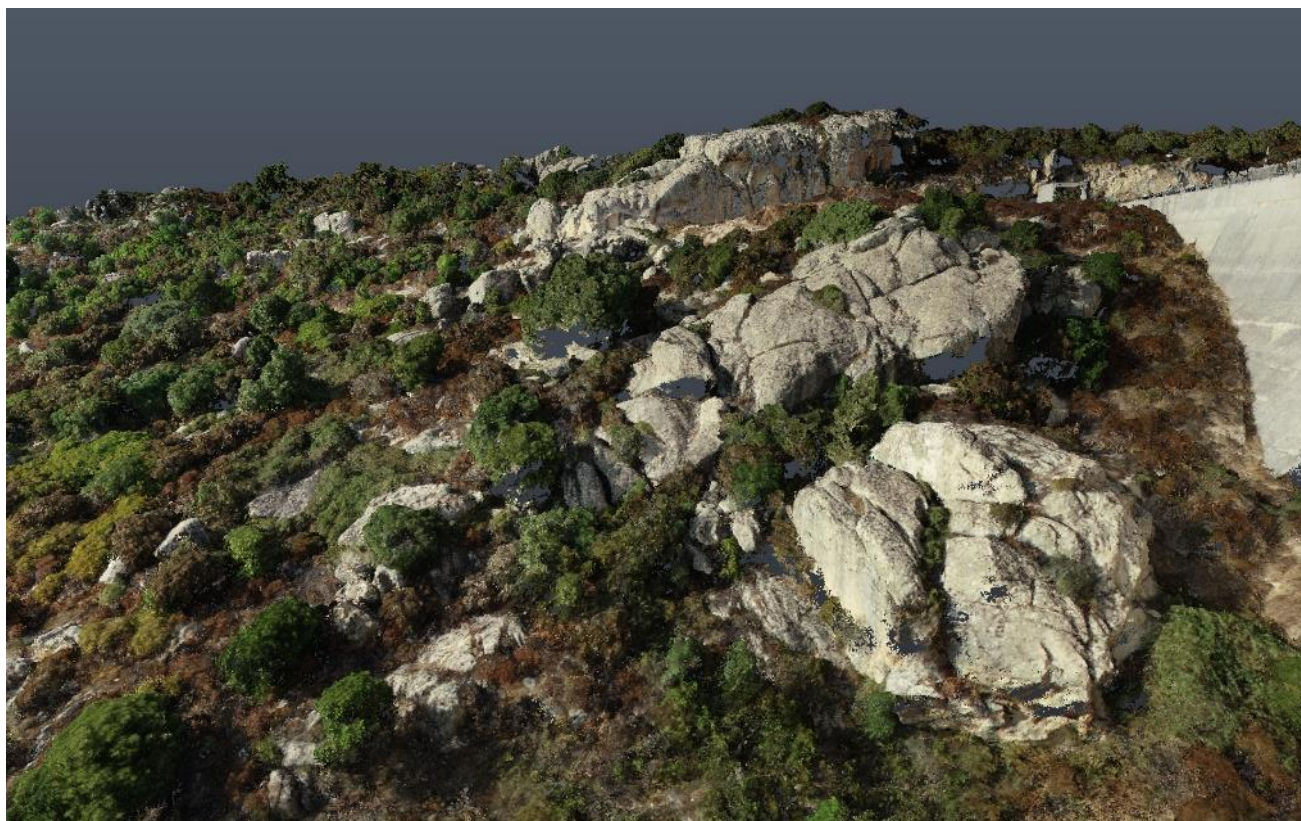
Figura 5-5 estratto nuvola di punti, rilievo del costone soggetto ad instabilità
