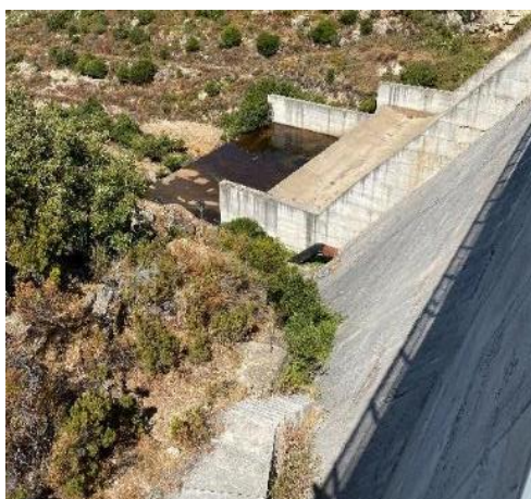
Figura 5-14 scala di accesso ai cunicoli lato Sud non terminata
