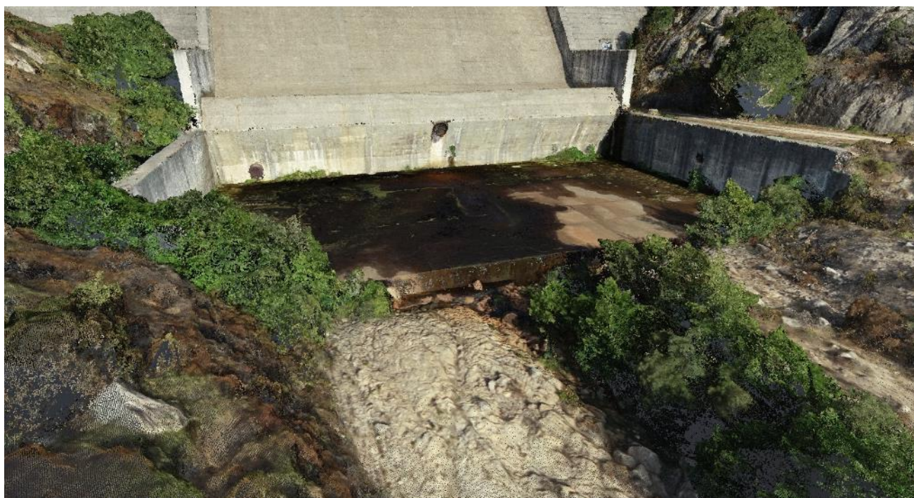
Figura 5-2 estratto nuvola di punti - erosione alla base della platea
