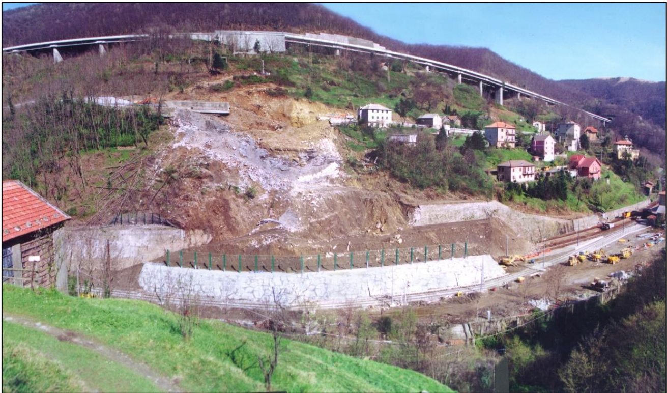
Figura 9 – Foto frontale della frana avvenuta nel Novembre 2000.
