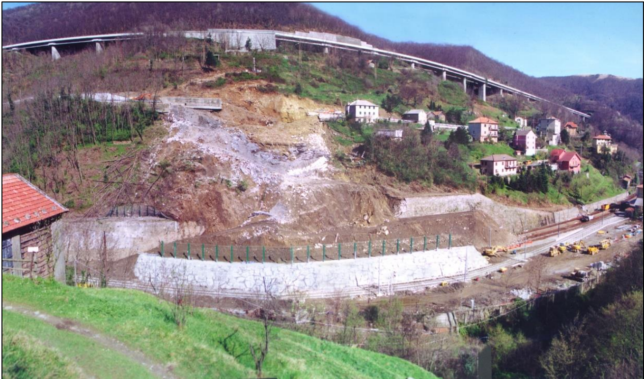
Figura 8 – Foto frontale della frana avvenuta nel Novembre 2000.
