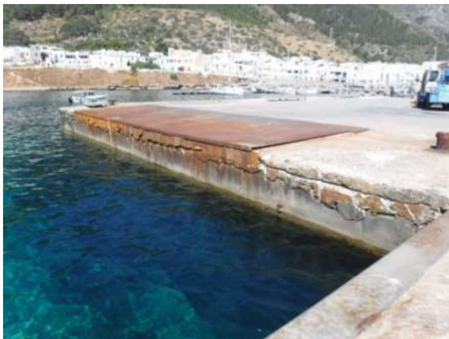
Fig. 4.8 - Banchina per attracco navi traghetto (attracco di poppa) e sullo sfondo pontile galleggiante per imbarcazioni da diporto.
