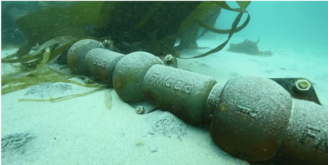
Figura 151: Esempio di protezione dei cavi gusci di ghisa (Fonte: FMGC Subsea Cable Protection System | Farinia Group).
