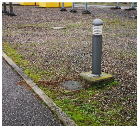
Figura 116: Esempio di palina di illuminazione.
