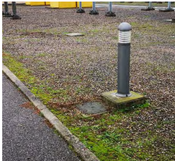
Figura 16: Esempio di palina di illuminazione.
