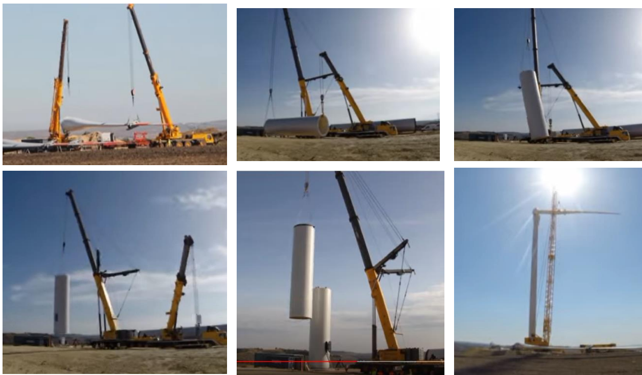
Figura 13 – Schema delle fasi di sollevamento dei componenti dell'aerogeneratore. Cantiere impianto della Società proponente Asja Ambiente Italia S.p.A. (Fonte https://www.youtube.com/watch?v=dEe5_RGTGgY ).
