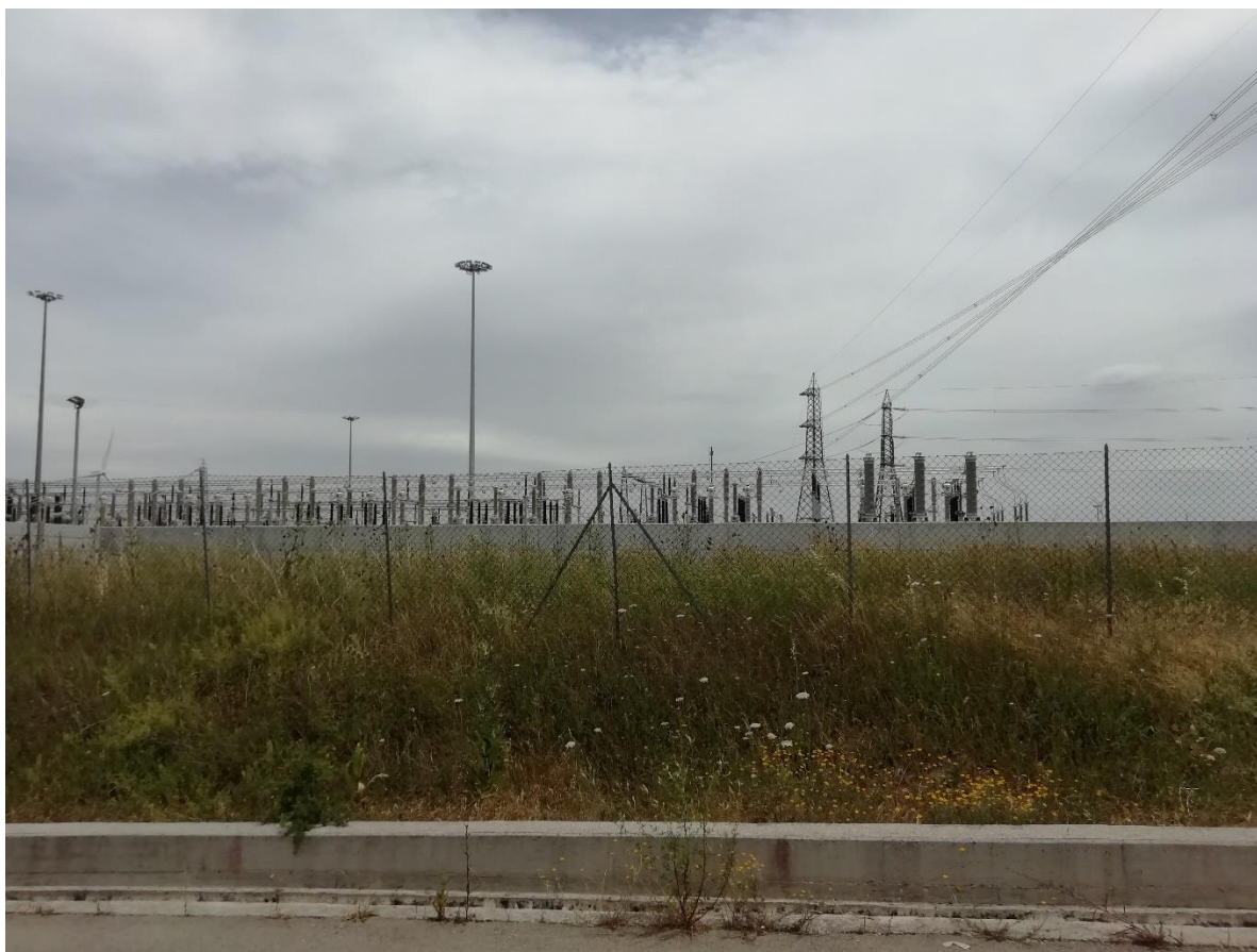
Figura 46 – Ripresa fotografica dal punto di vista numero 43. Stazione Elettrica Terna "Bisaccia".
