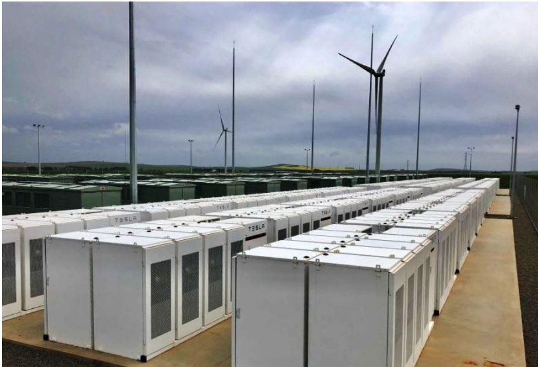
Sistema tipo di accumulo
