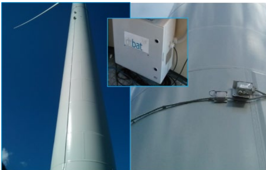
Figura 8 – Esempio di installazione di un sistema automatico su aerogeneratore per abbassare il rischio collisione
