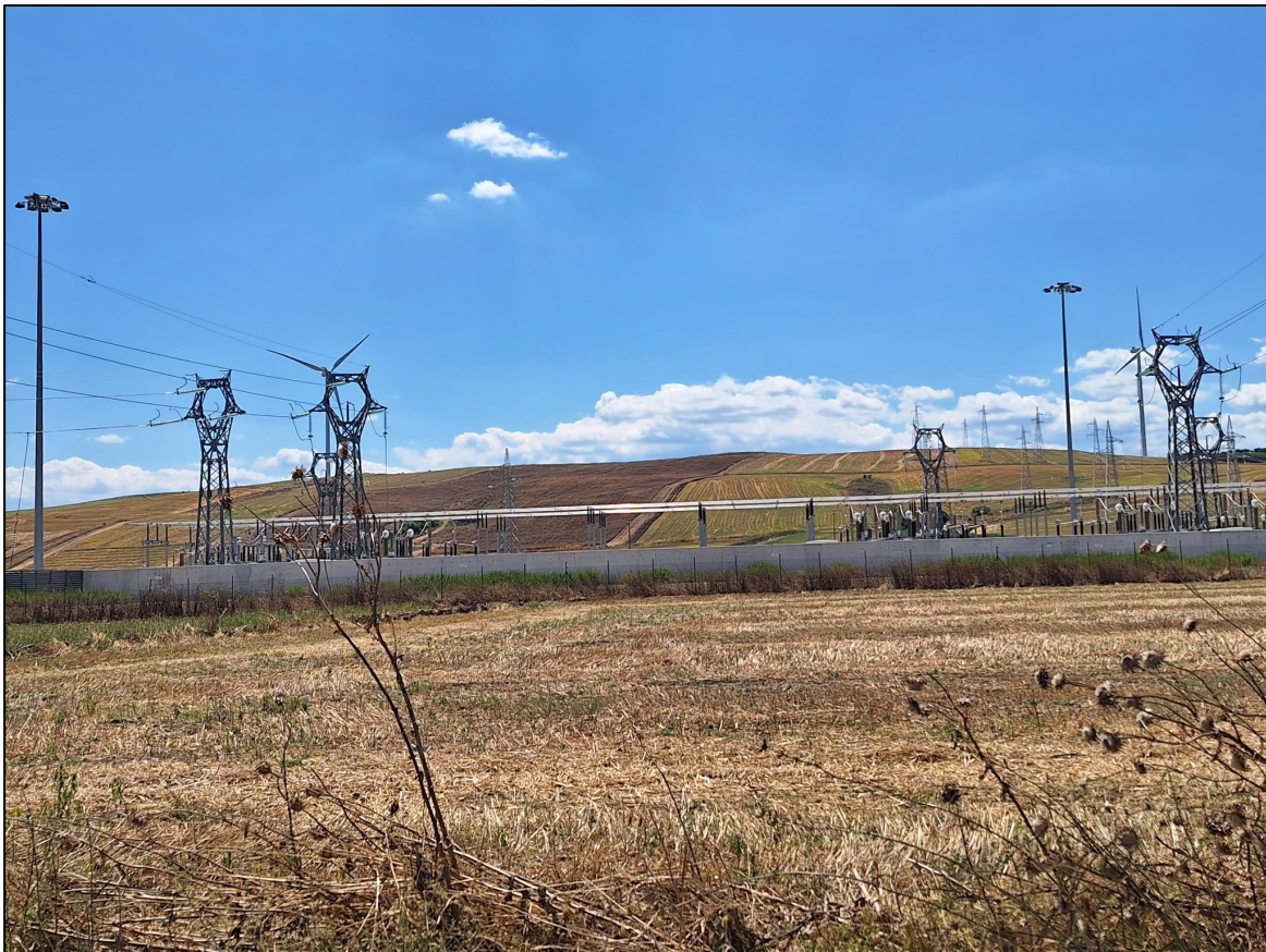
Figura 20 - Stazione Elettrica "Oppido Lucano", punto di connessione
