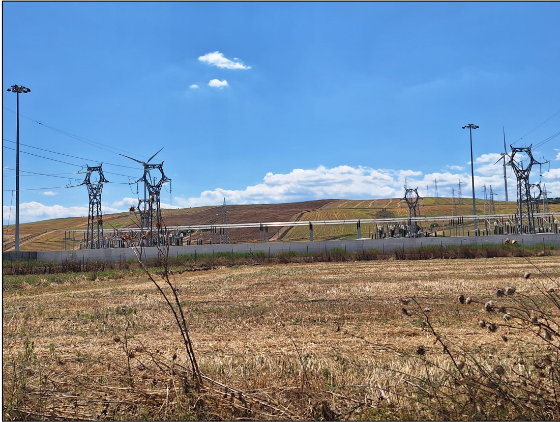
Figura 15 - Stazione Elettrica "Oppido", punto di connessione
