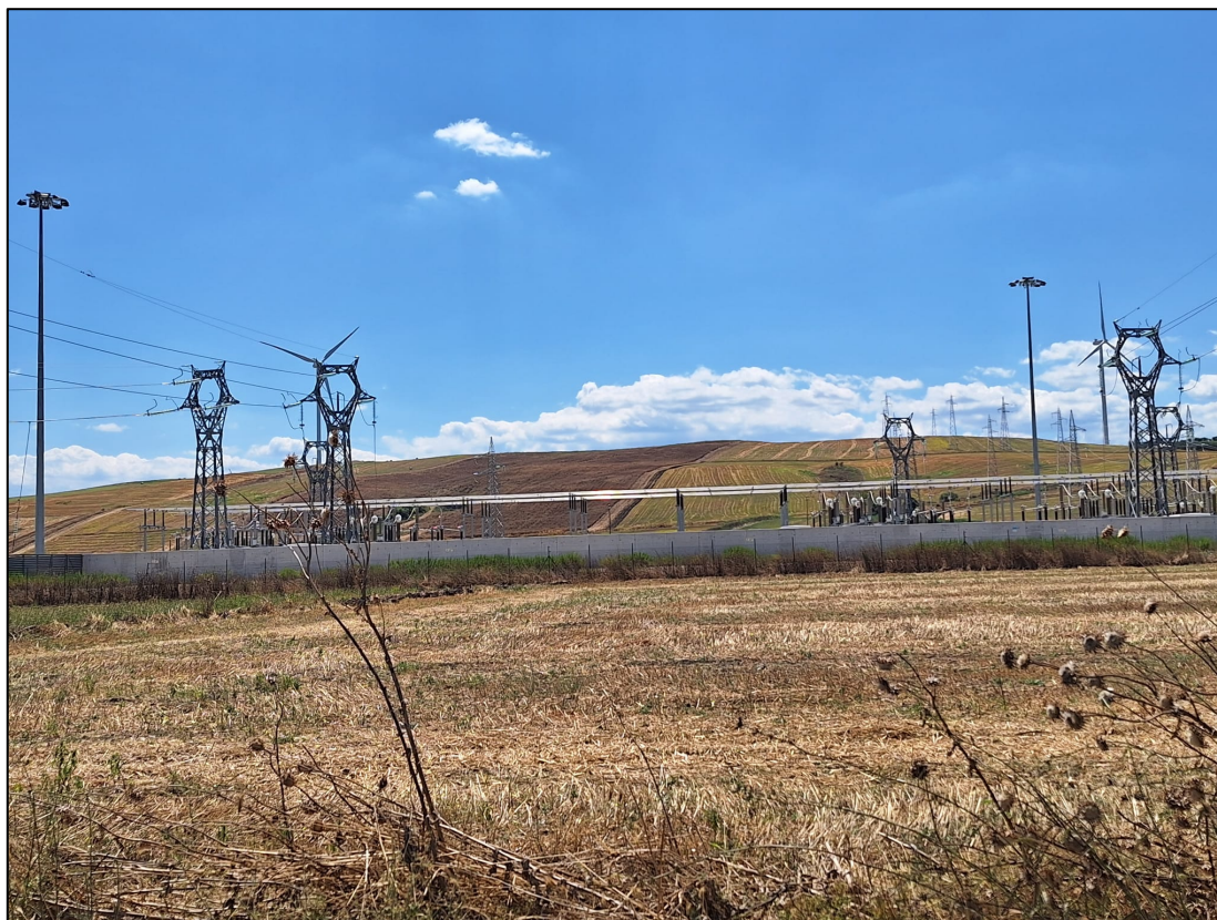
Figura 15 - Stazione Elettrica "", punto di connessione
