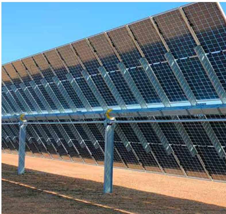
Figura 23: Particolare inseguitori monoassiali
