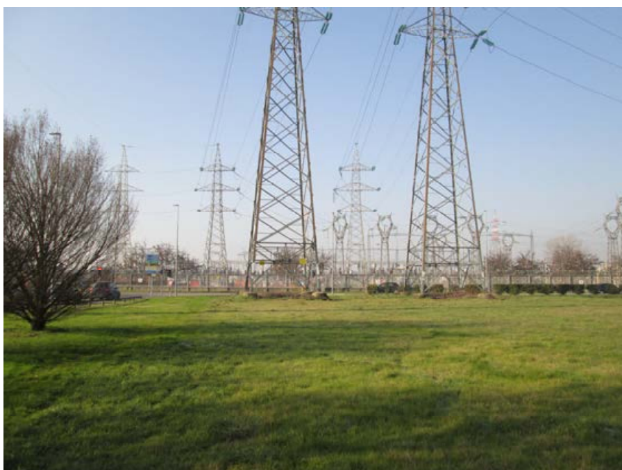
Figura 5.10 Via Edison nel punto di ingresso delle linee in progetto nella Stazione Elettrica Terna
