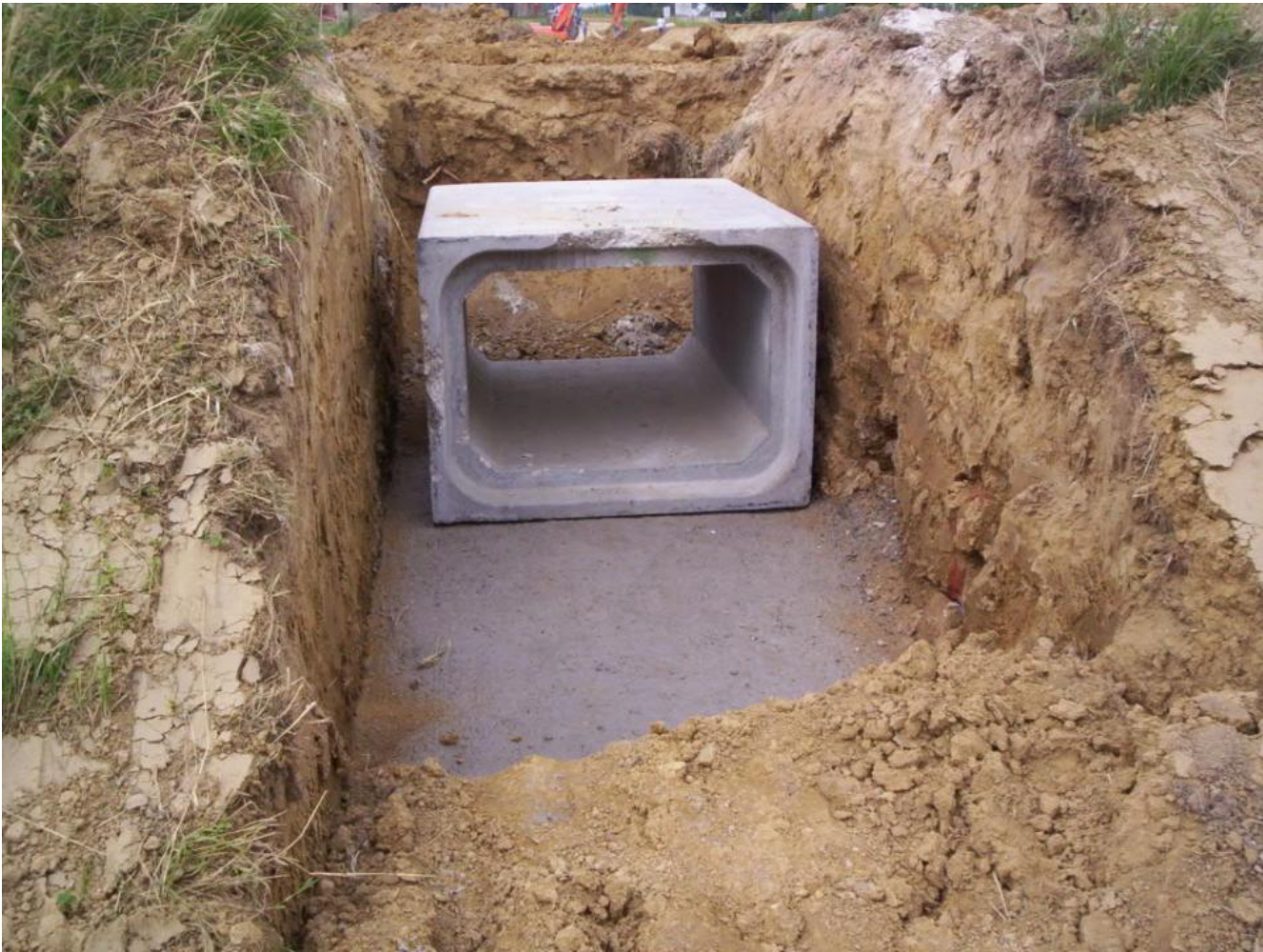
Figura 5-5: Attraversamento Fontnaile Testiole – Esempio di elemento scatolare utilizzato
