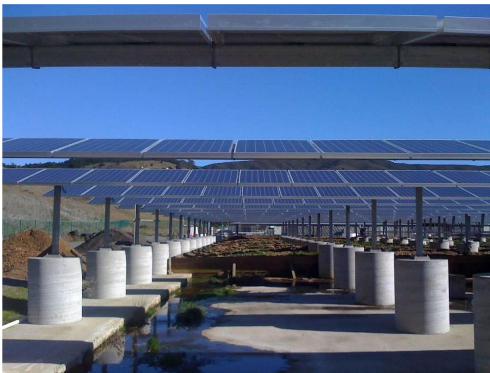
Fig. 53 _Esempio di impianto fotovoltaico con fondazioni formate da zavorre costituite da plinti in cemento
